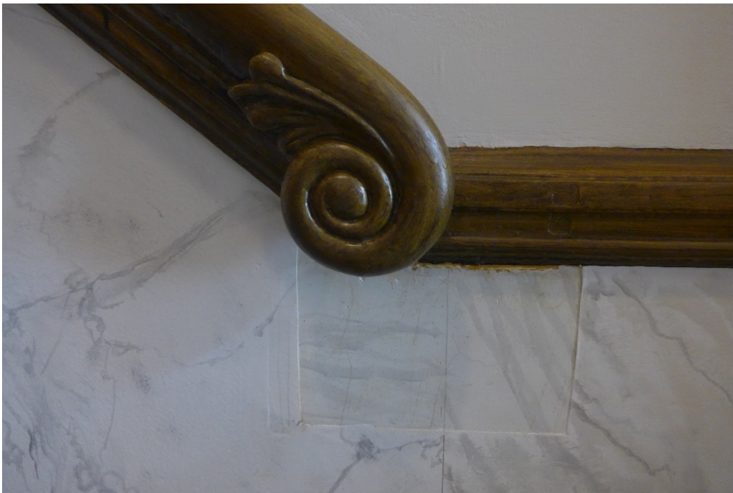
Detail van de gemarmerde lambrisering van de trap met in het venster de oorspronkelijk marmering
